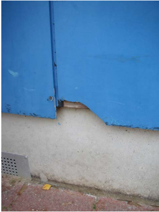
Kita Theodor-Heuss-Ring 132: Schäden an den Fassadenplatten und den Fenstern
