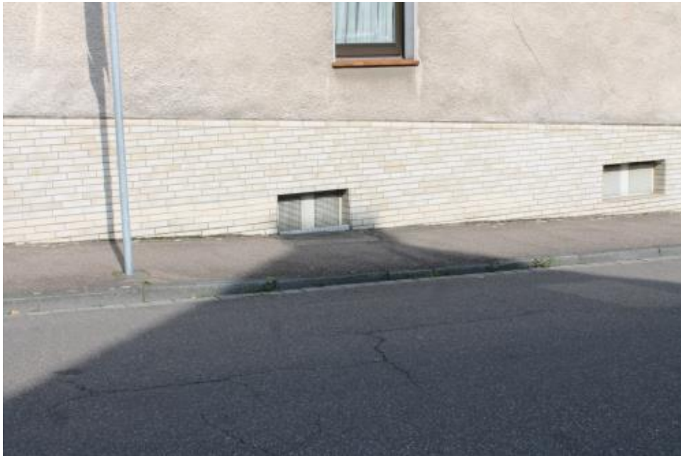
Abb. 1 Schadhafter Straßen- und Gehwegbelag [Quelle: eigenes Foto]
