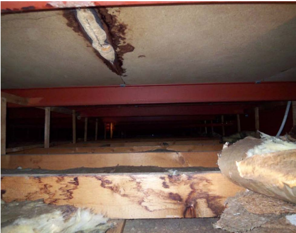
Schäden im Dach
