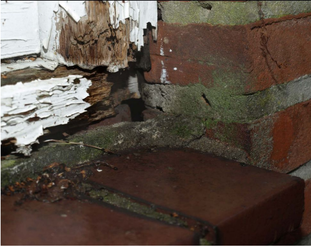
Schäden der Fenster
