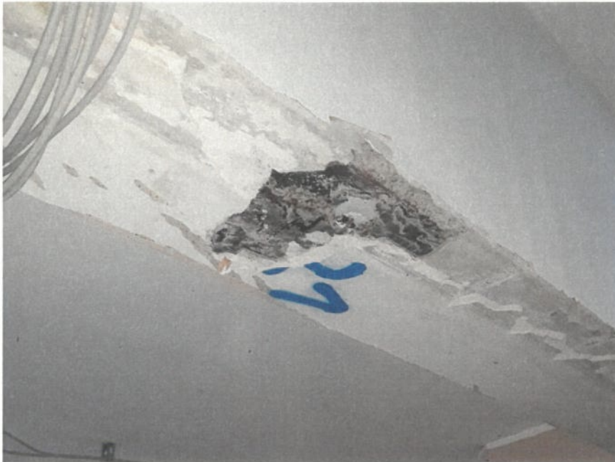
Abbildung 9: Stahlträger, Untersuchungsstelle N18.1
