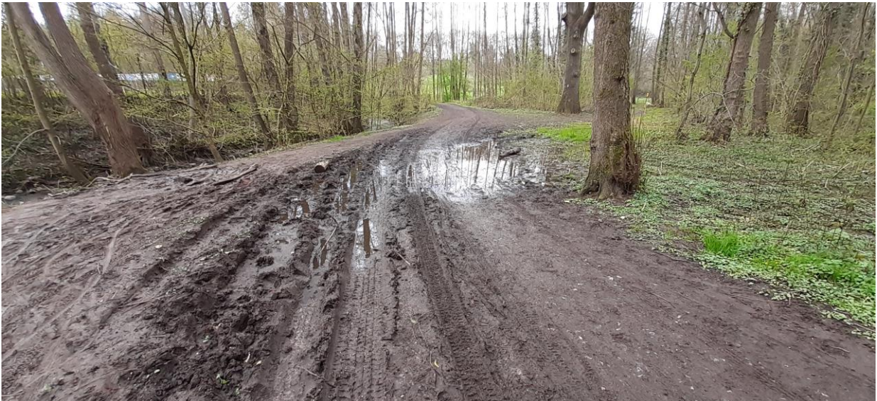
Schlechte Oberflächen zwischen Ölbach- und Brücke Wiembachbrücke
