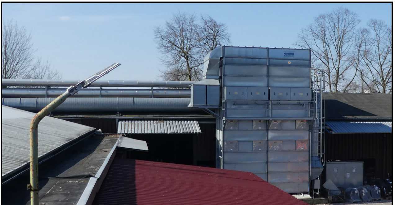
Abb. 3.1.3.1 Hofansicht der Randstreifenabsaugung
