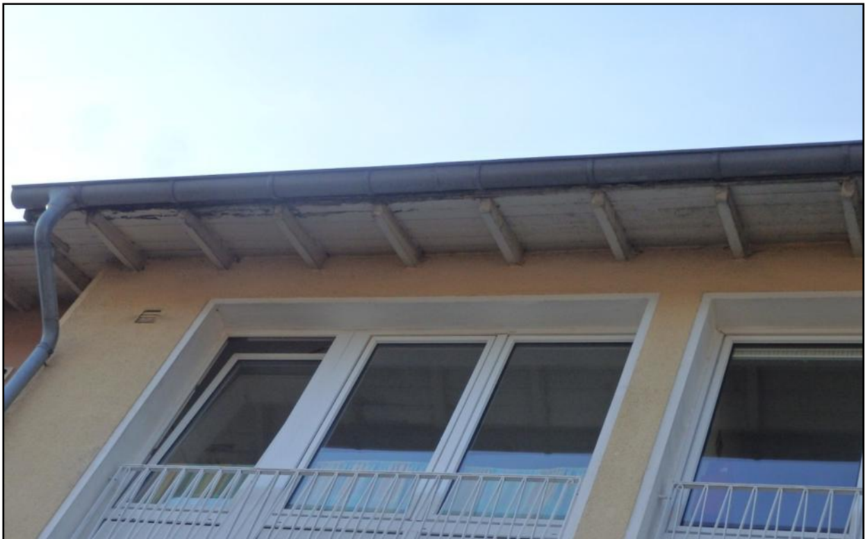
Abbildung 6: Spalten im Bereich des Dachüberstandes, die als Einschlüpfе für Zwergfledermäuse genutzt werden können.
