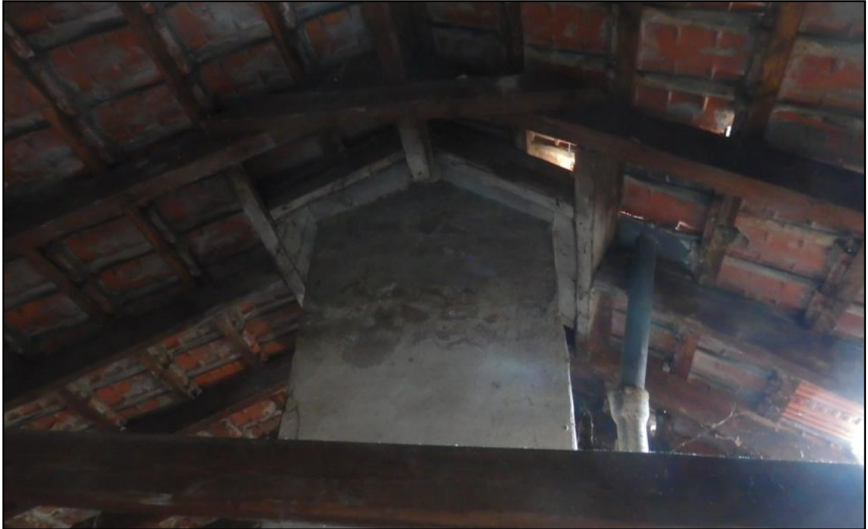
Abbildung 7: Spalten im Dach, die als Einschlüpfе für Zwergfledermäuse genutzt werden können.
