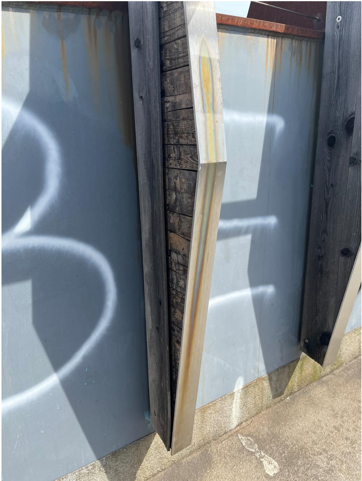
Abbildung 4: Ansicht 2024 mit Schäden
