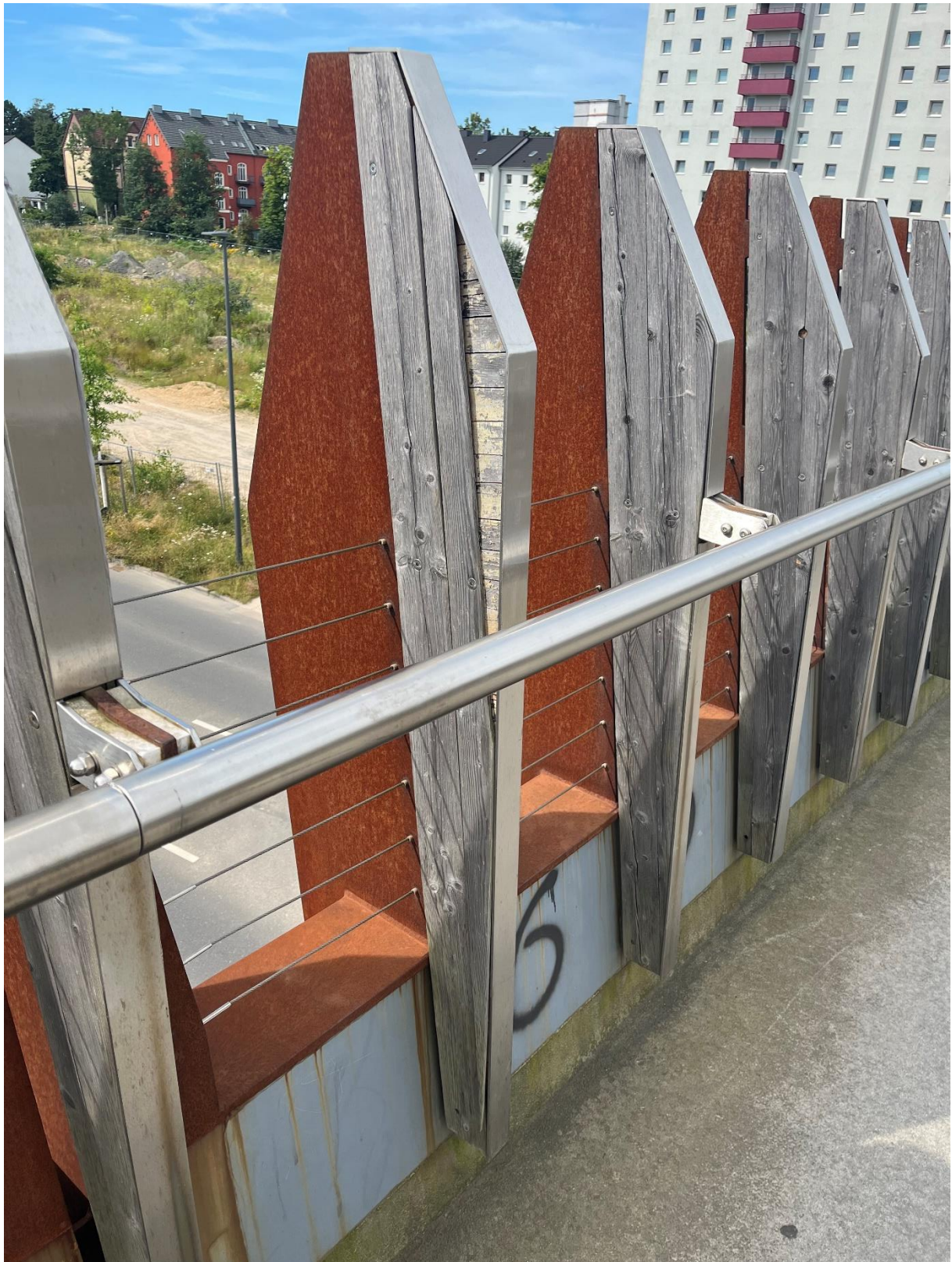
Abbildung 3: Ansicht 2024 mit Schäden
