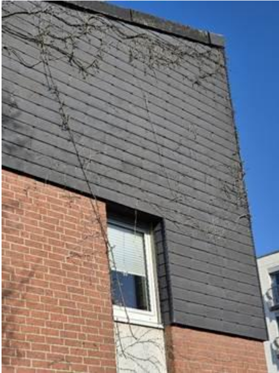
Abb. 9 Königsberger Pl. 28 mit Schieferfassade und Spalt entlang der Dachkante (Kraft.Raum. 2025)
