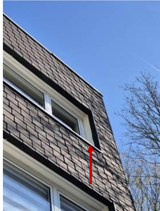
Abb. 22 Memelstraße 4, Bericht einer Anwohnerin über Kotspuren auf Fensterbank (Rote Markierung) (Kraft.Raum. 2025)
