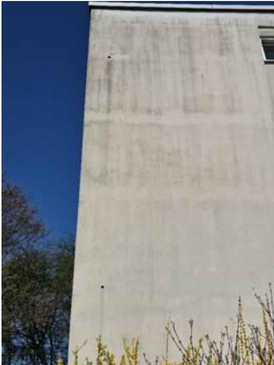
Abb. 7 Löcher in Fassade verursacht von Halsbandsittichen (vgl. Abb. 25) (Kraft.Raum. 2025)
