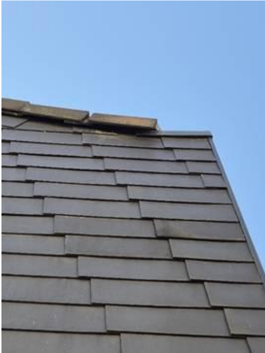
Abb. 21 Spalt zwischen Dachkante und Schieferfassade (Kraft.Raum. 2025)
