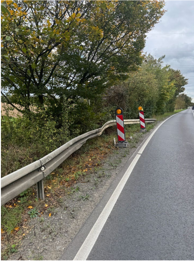
Anlage 1 zum Antrag Reparatur der Leitplanke Langenfelder Straße / Neujudenhof Bilddokumentation der defekten Leitplanke an der Langenfelderstraße/Neujudenhof / Ansicht Fahrtrichtung Leverkusen
