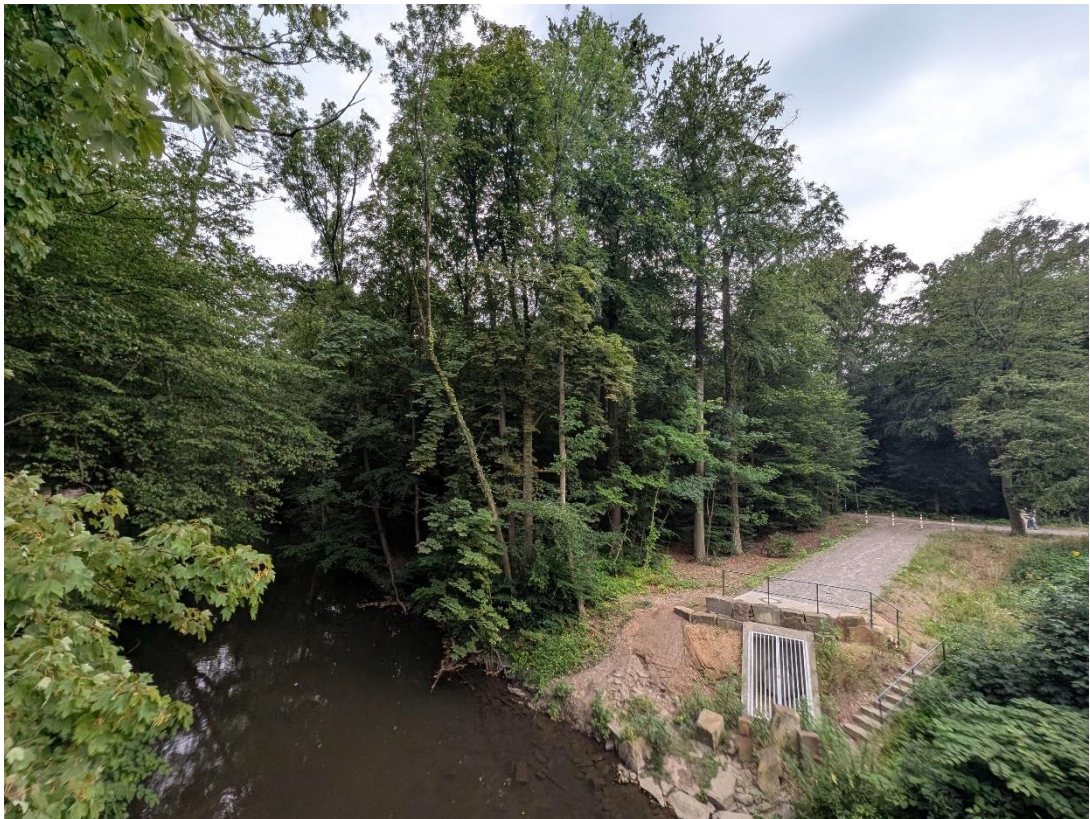
Bild 6: neue Einleitstelle von Niederschlagswasser in die Dhünn der Technischen Betriebe der Stadt Leverkusen.
