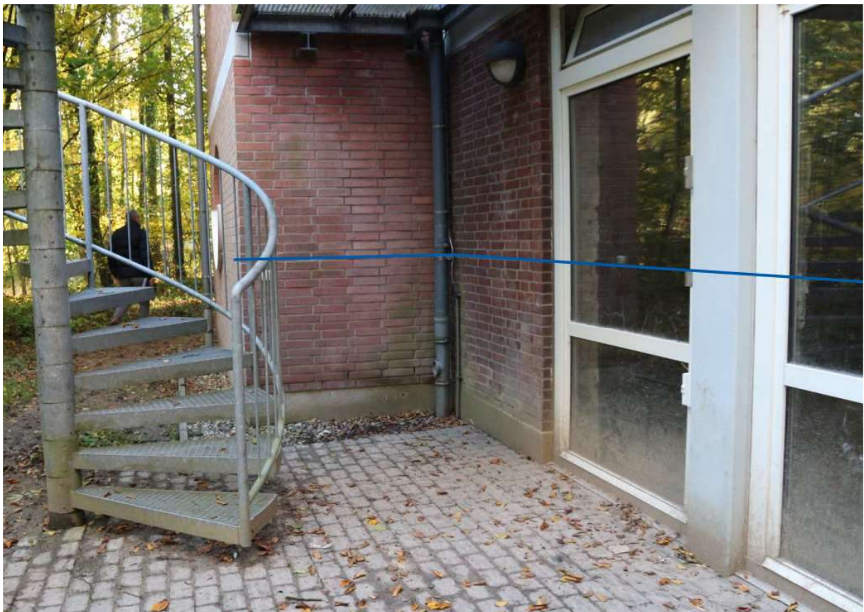
Abbildung 21: M1.2 Wasserstand (blau) am Gebäude 4 am 14./15. Juli 2021
