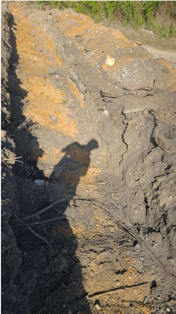
Abbildung 3: Alte Kabel im Untergrund des Baufeldes
